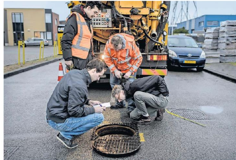
▲ Aan de Stavangerweg wordt de bijna vijftien jaar oude riolering getest. Enerzijds om te kijken naar de staat van het buizenstelsel, anderzijds wordt een nieuwe manier van schoonmaken en onderhoud getest. Foto Jan Zeeman
